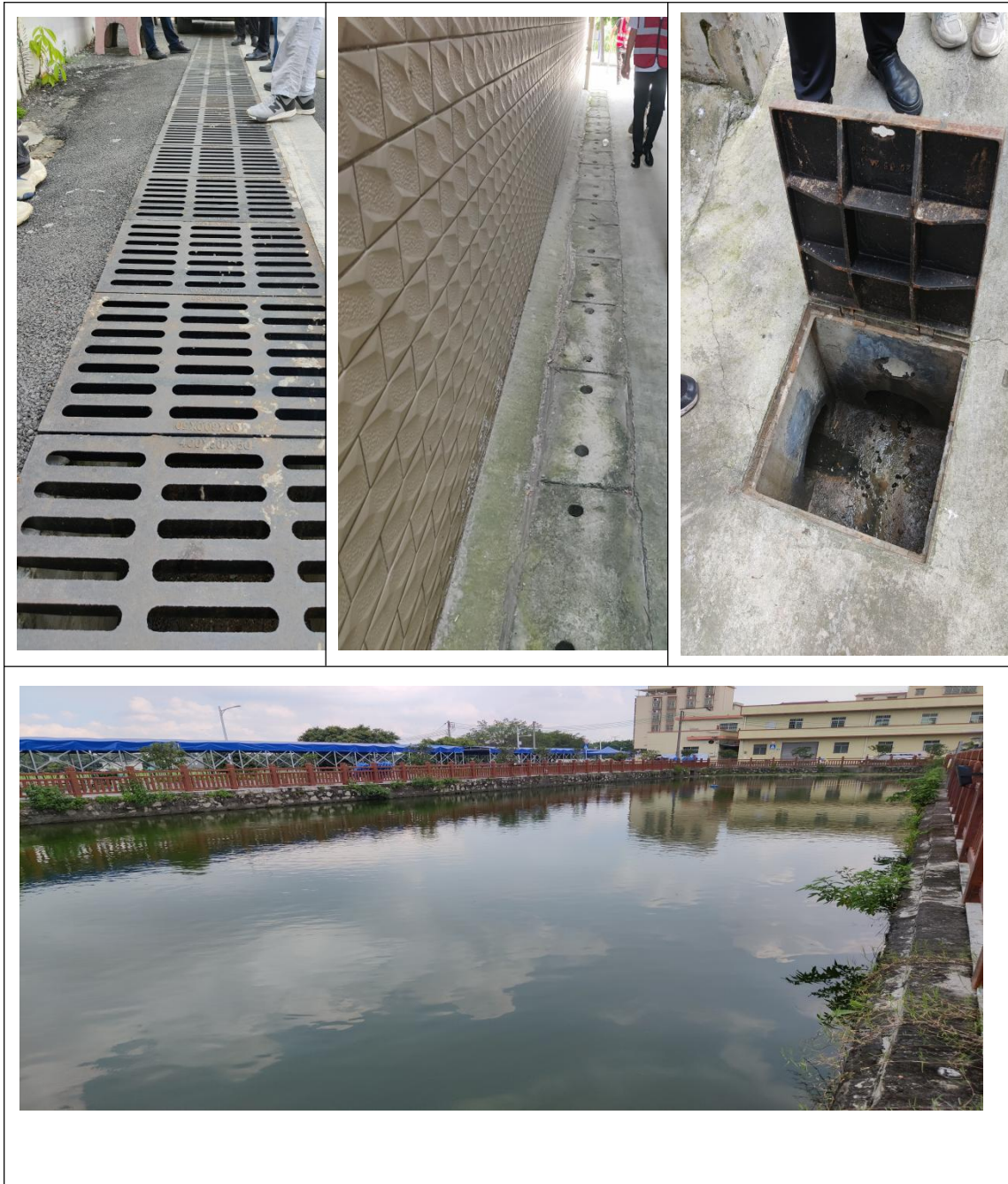
图 4-3 水污处理地下管道及雨水排向（池塘）
